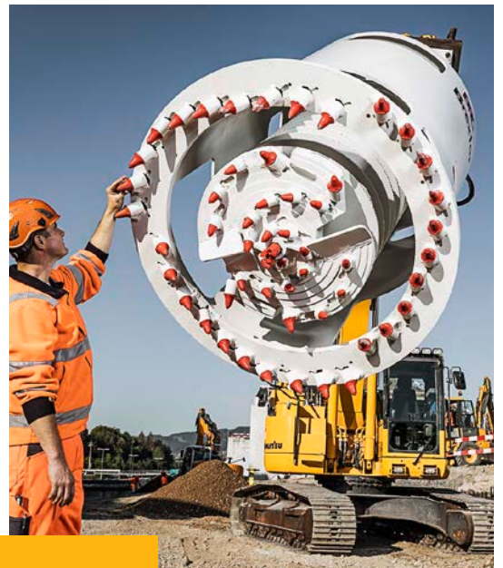
Auch die neue Pfähkopfräse Brextor kommt auf der Baustelle in Opfikon zum Einsatz.
